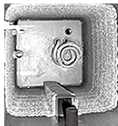
スケールが付着したタンク
