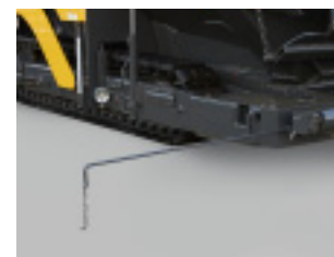
走行指針照明灯
