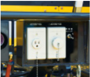
コンセント部
