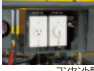
コンセント部
