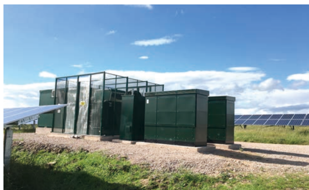
場所：カーライル イギリス 連系開始：2016年 容量：5MW
